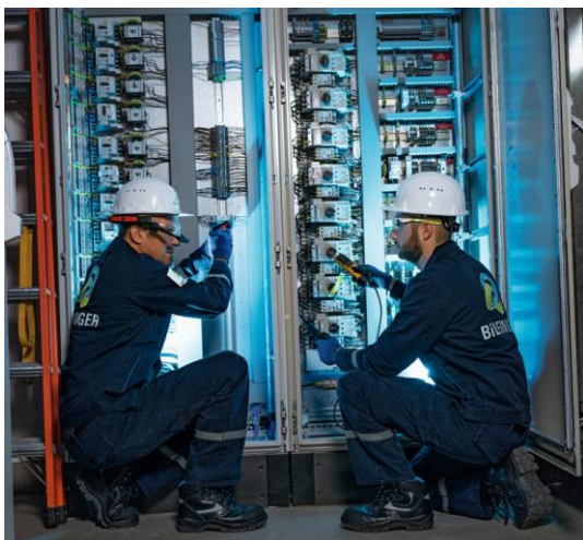
Bild 2: Das Portfolio von Bilfinger umfasst auch Elektrifizierungsleistungen
