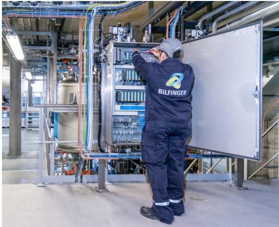
Bild 1: Bilfinger liefert Elektro- und Leittechnik zur effizienteren Einspeisung von Fernwärme
