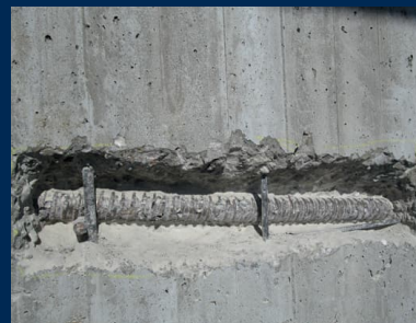
Freigelegtes Hüllrohr an einer Brücke
