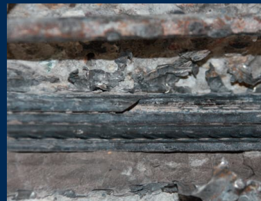
Gebrochener Spanndraht an einer Brücke
