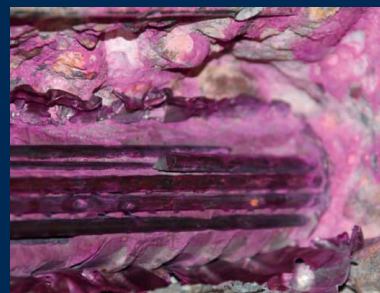
Weiterer gebrochener Spanndraht an einer Brücke
